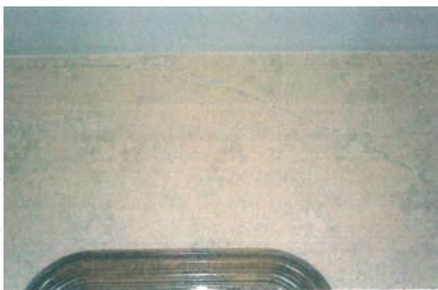
Fissuration intérieure, tapisserie déchirée - Maison André.
